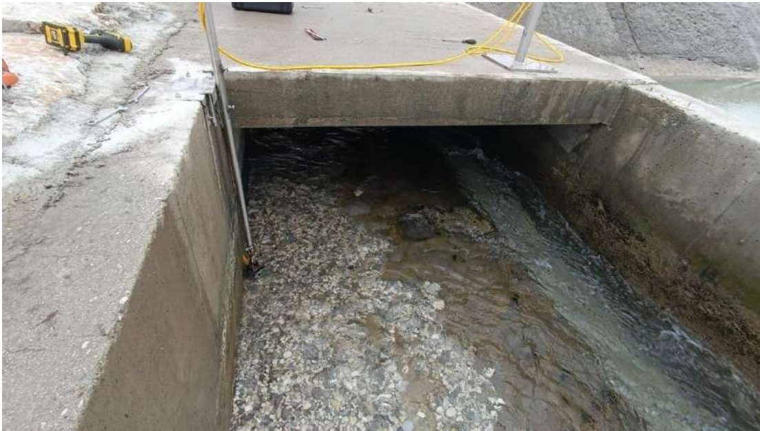
Figura 9: Alloggiamento della telecamera lungo la scala di risalita.
