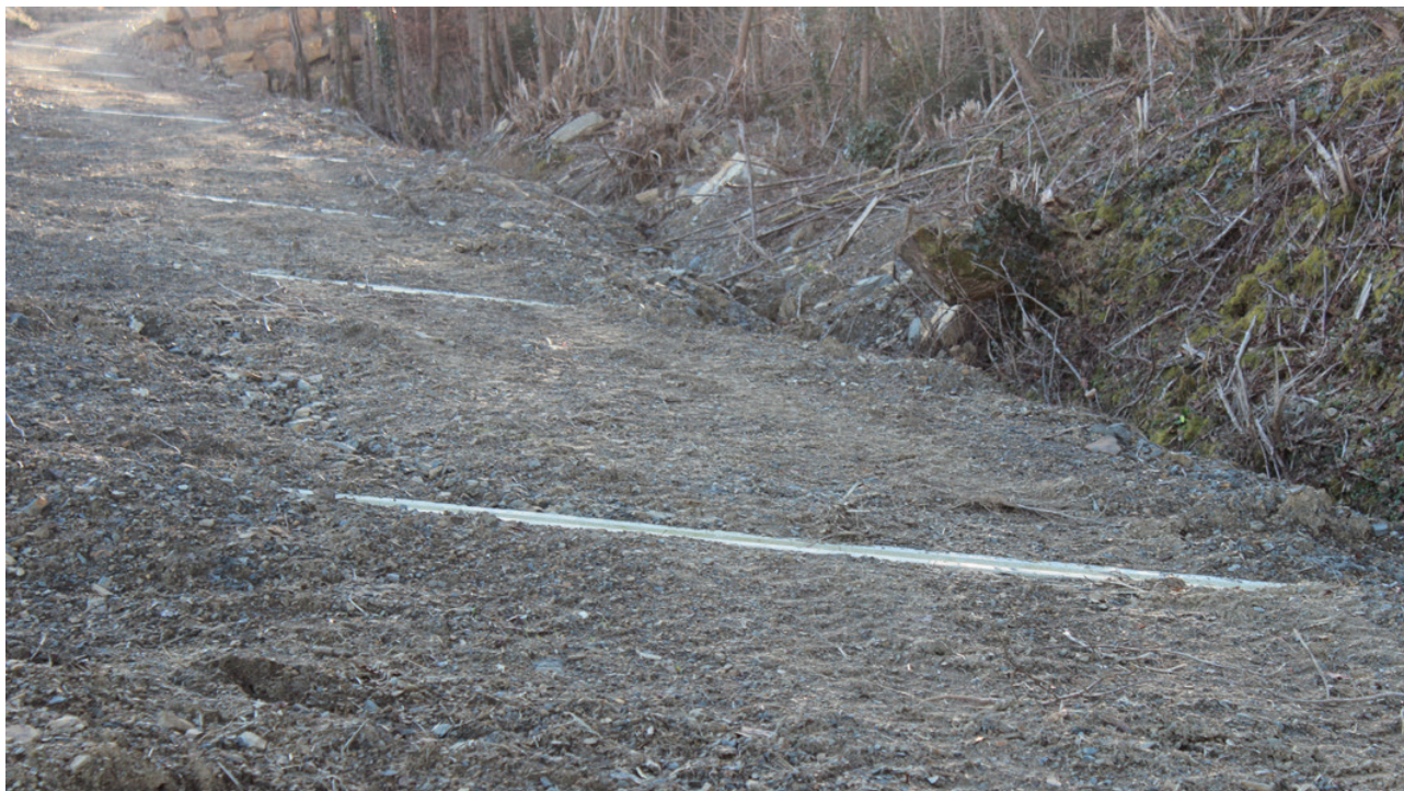
Figura 14: Drenaggio mediante canalette di deflusso verso un impluvio naturale (foto: archivio KGZ Nova Gorica)
